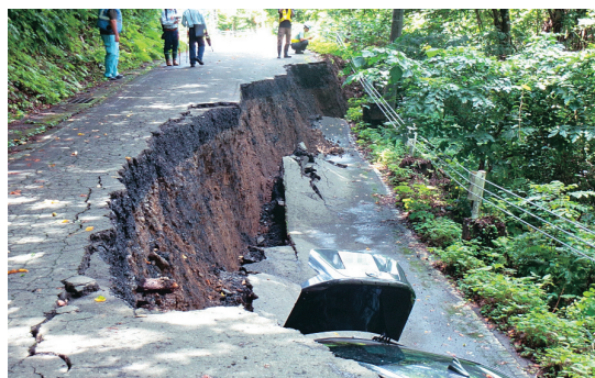
県道12号花巻大曲線一部崩落
