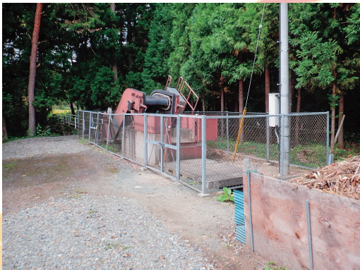
上段：大畑2揚水機（主ポンプ更新） 下段：北湯口2除塵機（整備補修）
