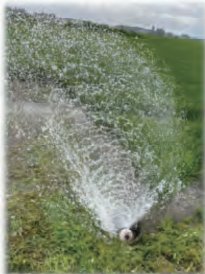
給水栓破損事故
