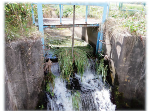
中央用排水路ゲート
